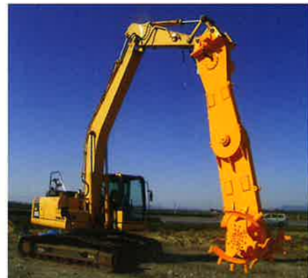
ブームランプレート装着でN値38の礫混じり砂層に対応
